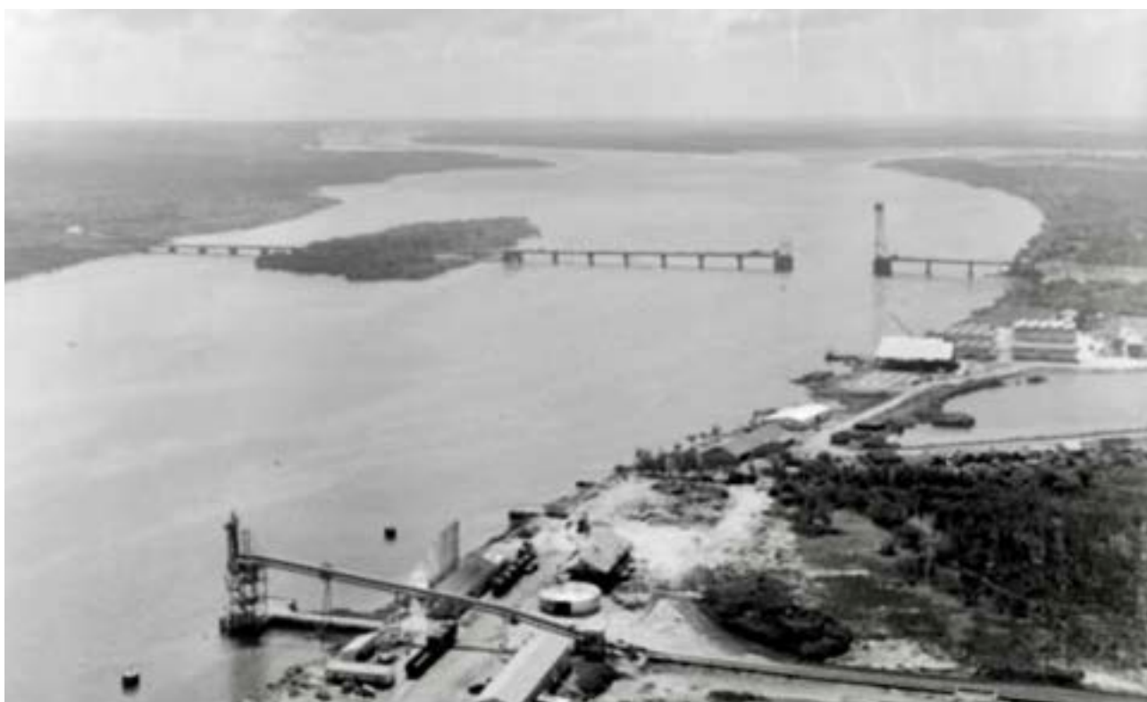
EMBARCADERO sobre el río Coatzacoalcos. Al fondo el puente Coatzacoalcos I, en construcción, 1960. Foto Casasola, Mediateca INAH.
